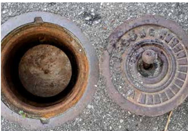
Abb. 2: Lagefixpunkt unter Vermessungsschacht
